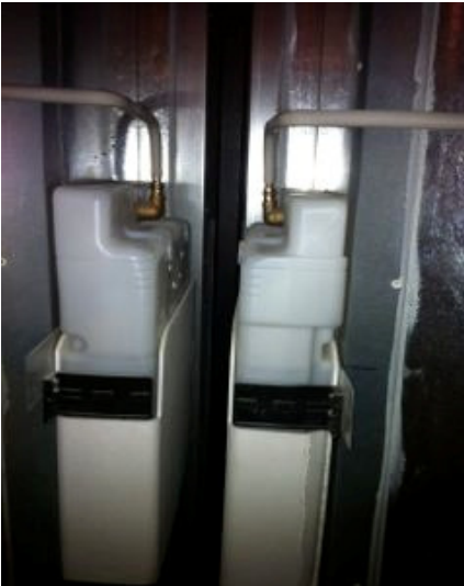
Inefficient high-volume toilet cisterns
